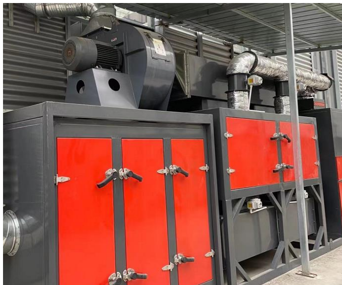
图4-3 浸漆废气处理设施（活性炭吸附+催化燃烧）相关照片
